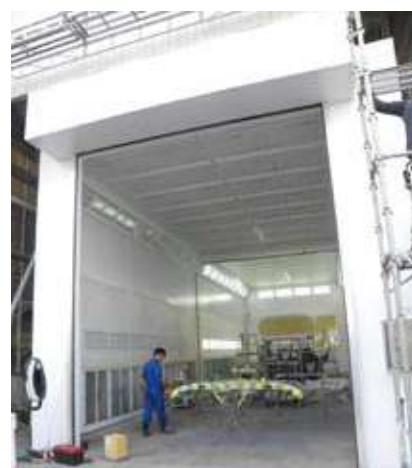
県内初導入の大型車用塗装ブース
