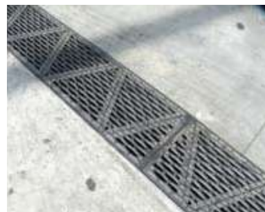
洗車場のグレーチングも重量物に対応
